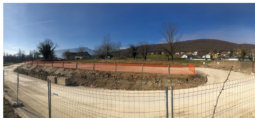
Aménagement de la voirie de chantier sur le parc d'activités de Pont Pierre
