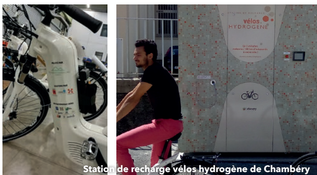
Station de recharge vélos hydrogène de Chambéry
